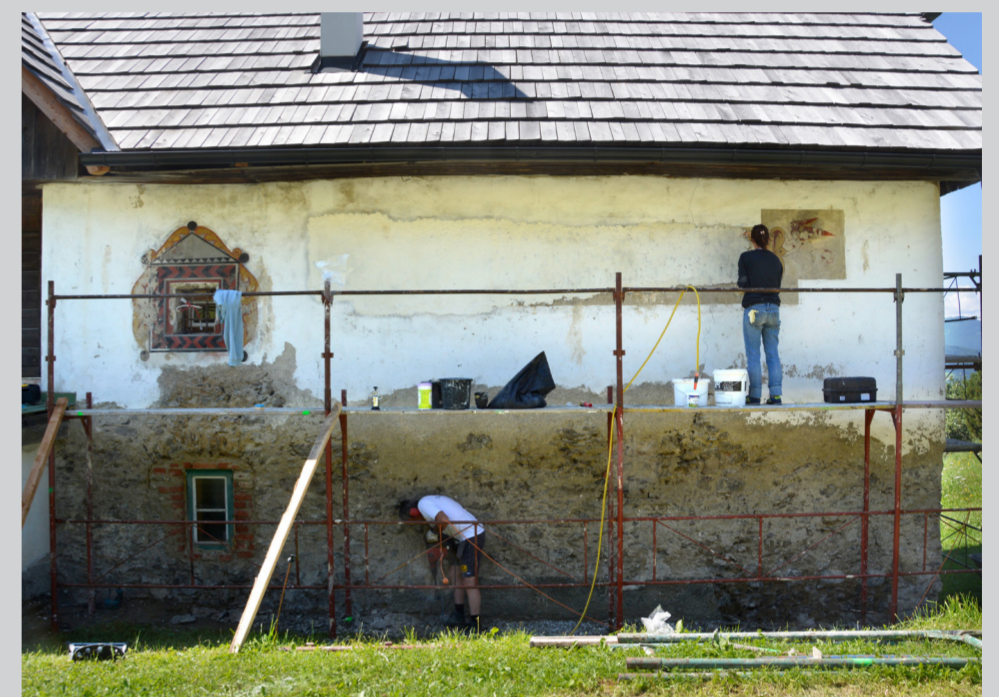
Zwischenzustand, Entfernung des schadhafte Putzes im unteren Bereich, Reduzierung der Vergipung an den Malereien mit Ammoniumkarbonat-kompressen
