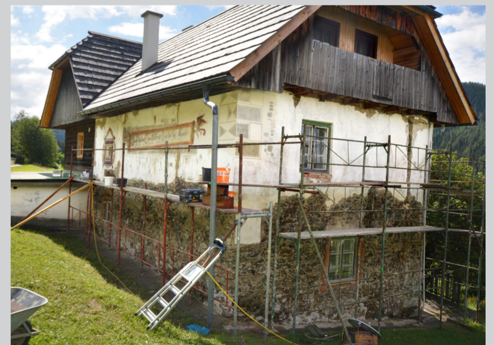
Zwischenzustand von NW, während Putzergänzung, im oberen Bereich mit Probeflächen für Anstrich, Eckquader, Putzergänzung unten
